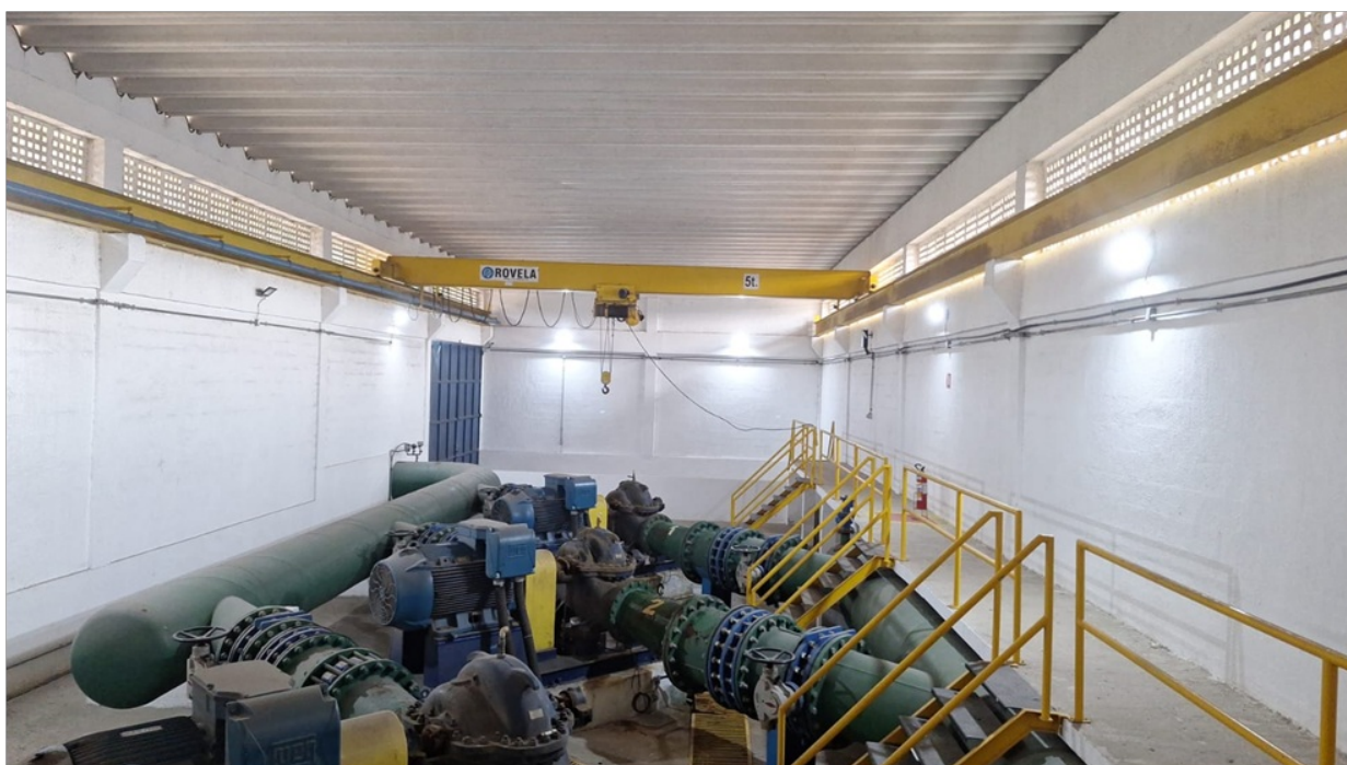
Foto 5 - Vista interna da montagem, com a sucção a direita e o recalque a esquerda. Ponte rolante acima para manutenção.
