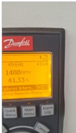
Foto 8 - Instrumento de medição do quadro elétrico com leituras de frequência do motor, rotação do motor , percentual de eficiência, e amperagem.
